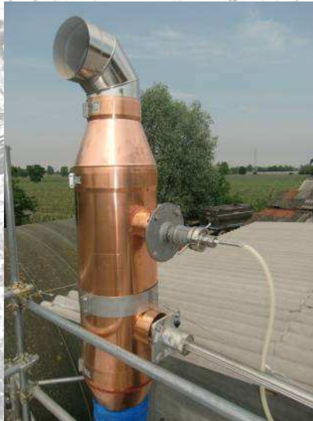
Sezione speciale del camino: tronchetti di prelievo per fissaggio sonda di campionamento
