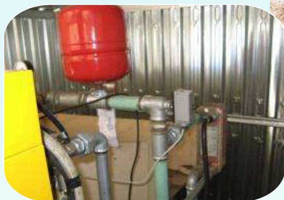
Scambiatore di calore
